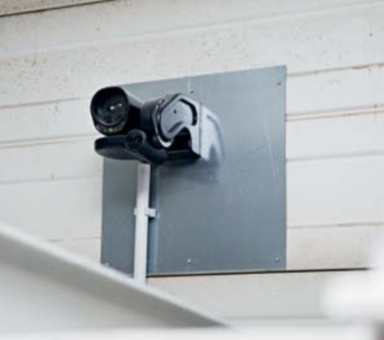
Sender und Empfänger der linienförmigen Rauchmelder Ilia Dust sind an den Seitenwänden unterhalb der Decke montiert.
