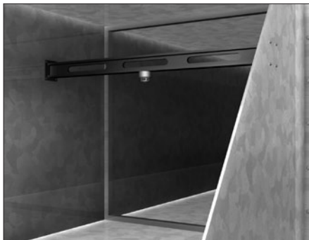
Rauchschalter im begehbaren Kanal
