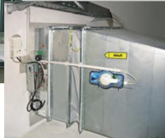
Das Lüftungs-Rauchschalter-System LRS 03 steuert die Brandschutzklappen im Polizeirevier an (kleines Bild). Störungsmeldungen werden auch zur Zentrale der Polizeiwache weitergeleitet (großes Bild).
